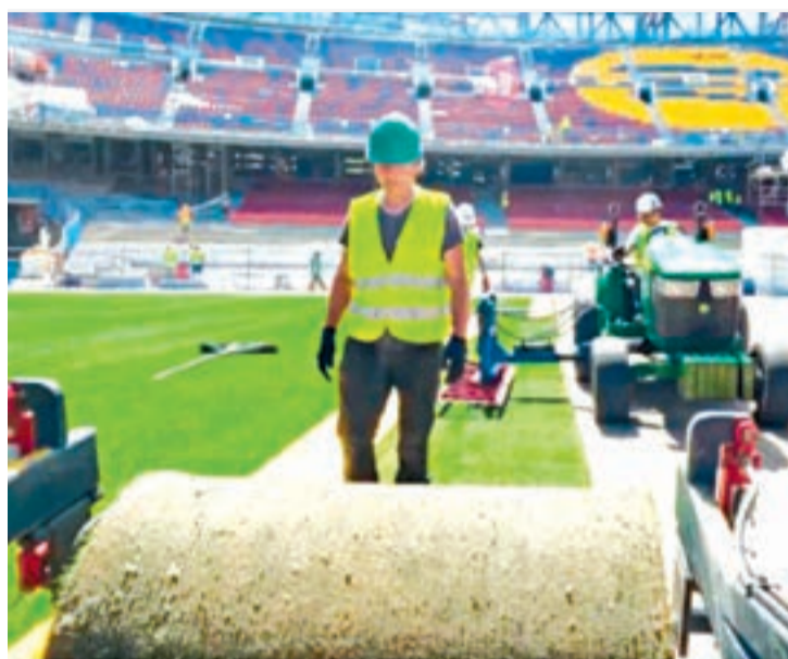
FOTO_ FCB Un operari desembala un rotlle de gespa al nou Camp Nou en les obres del nou estadi blaugrana
