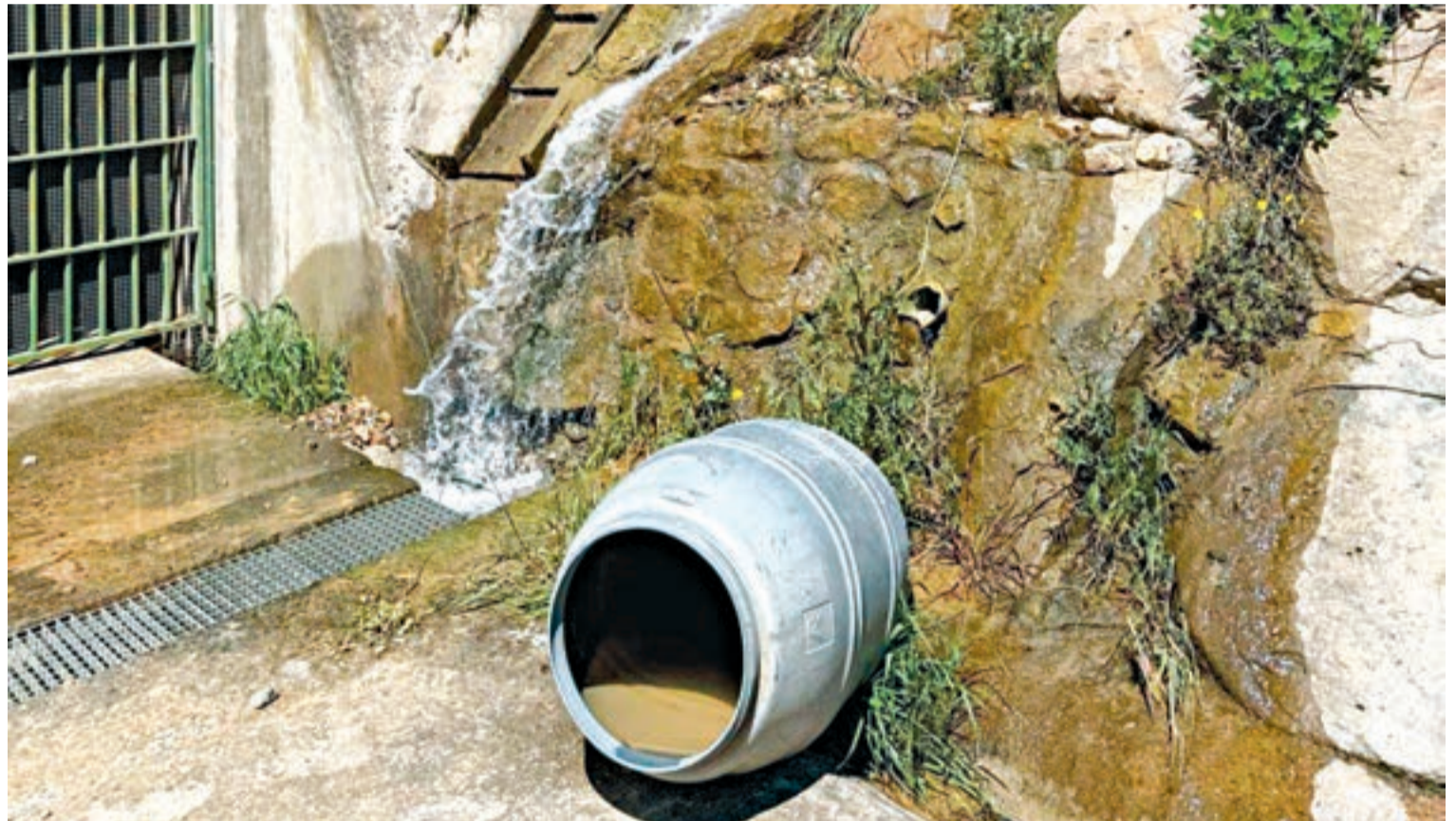
FOTO_Confederació Hidrogràfica de l'Ebre Imatge de la filtració detectada dimarts a la presa de Rialb
