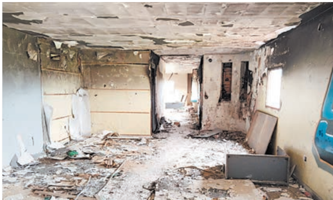
FOTO_ D.A. L'equipament ha patit saquejos, incendis i destrosses
