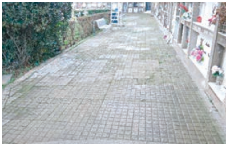
FOTO_ La Paeria Paviment en mal estat al cementiri
