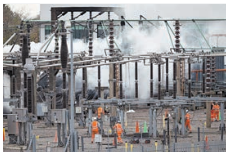
FOTO_ Tolga Akmen (EFE) La subestació elèctrica incendiada que va deixar l'aeroport sense llum
