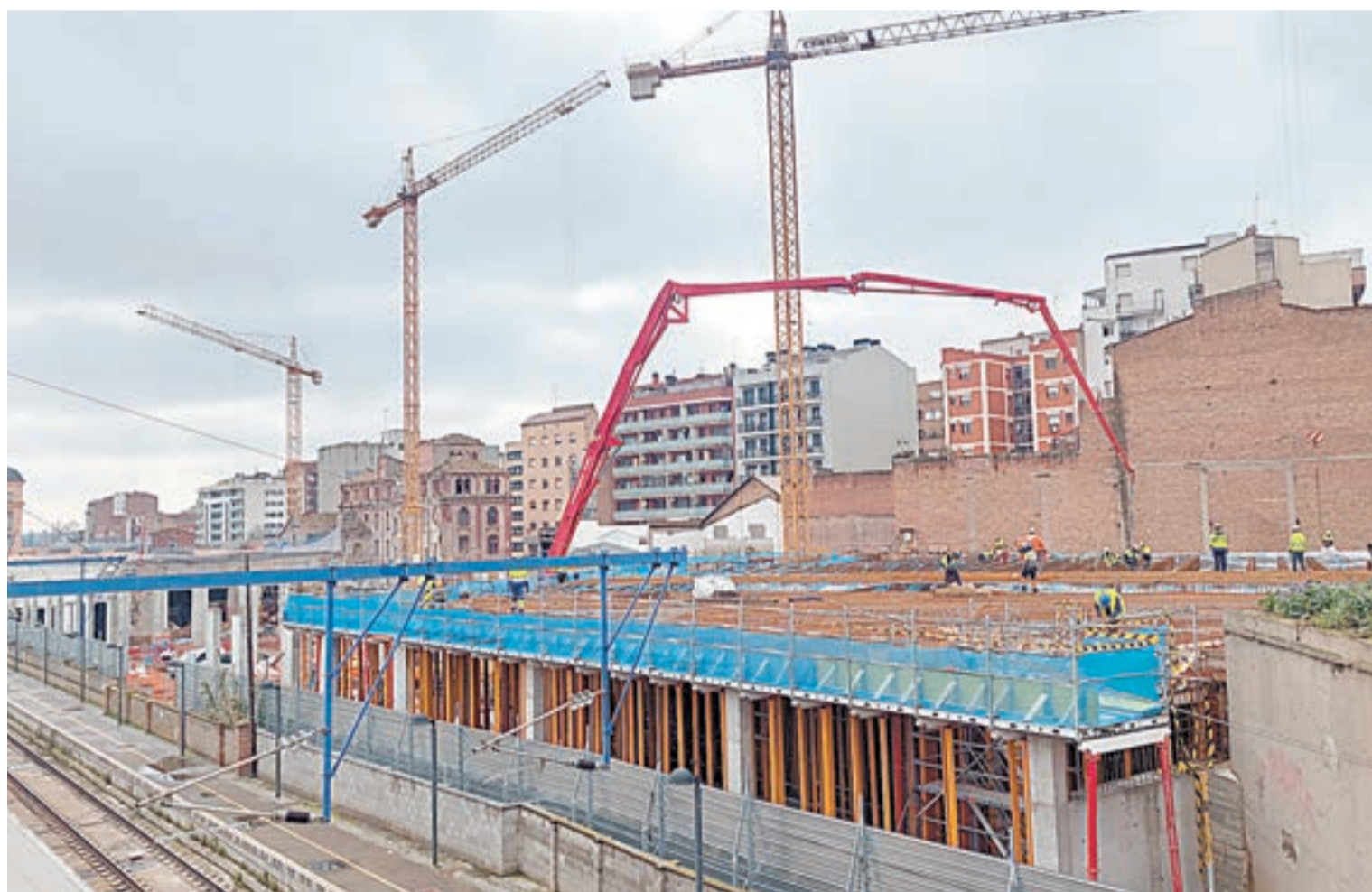
FOTO_ Tony Alcántara Operaris treballen a la teulada de les futures cotxeres de l'estació d'autobusos de Lleida
