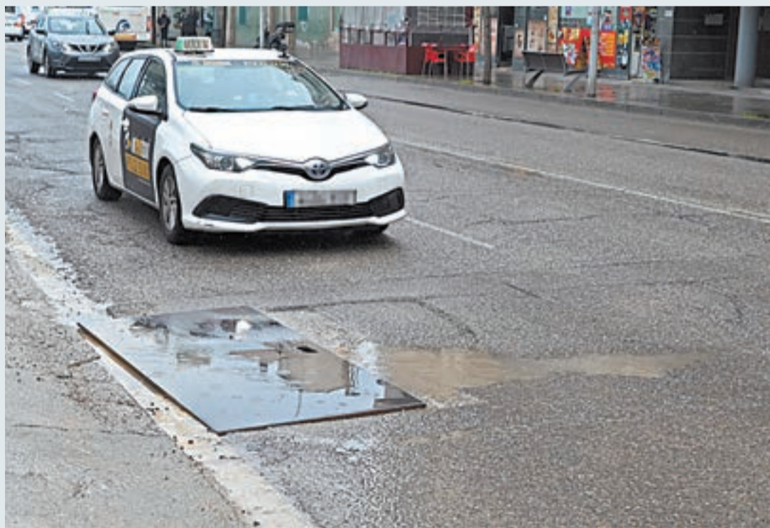
FOTO_ Núria García Un dels trams danyat pel pas dels camions de l'obra
