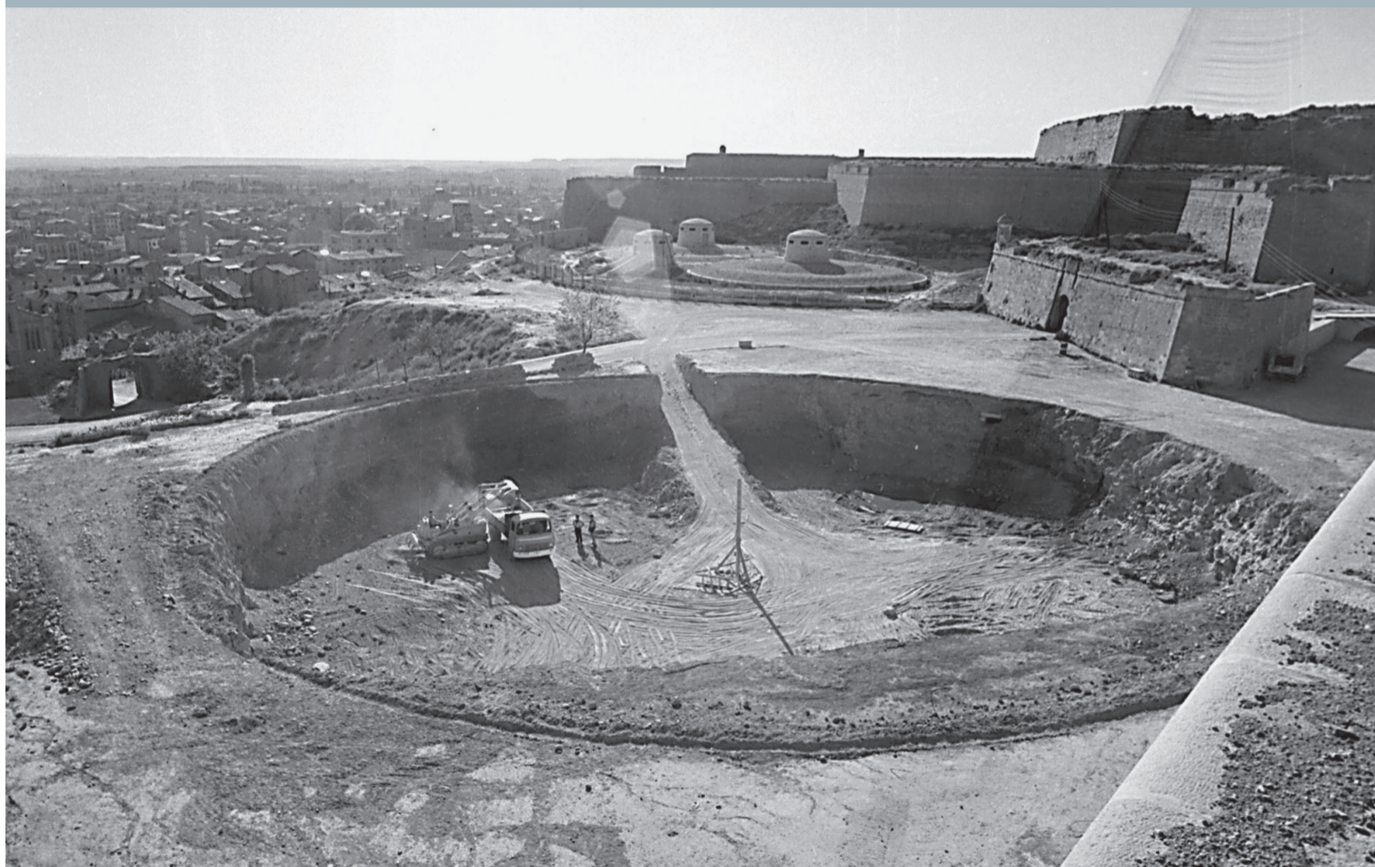
Imatge de la construcció del dipòsit d'aigua a la Plaça de la Sardana / Fons Gómez Vidal (sense datar)
