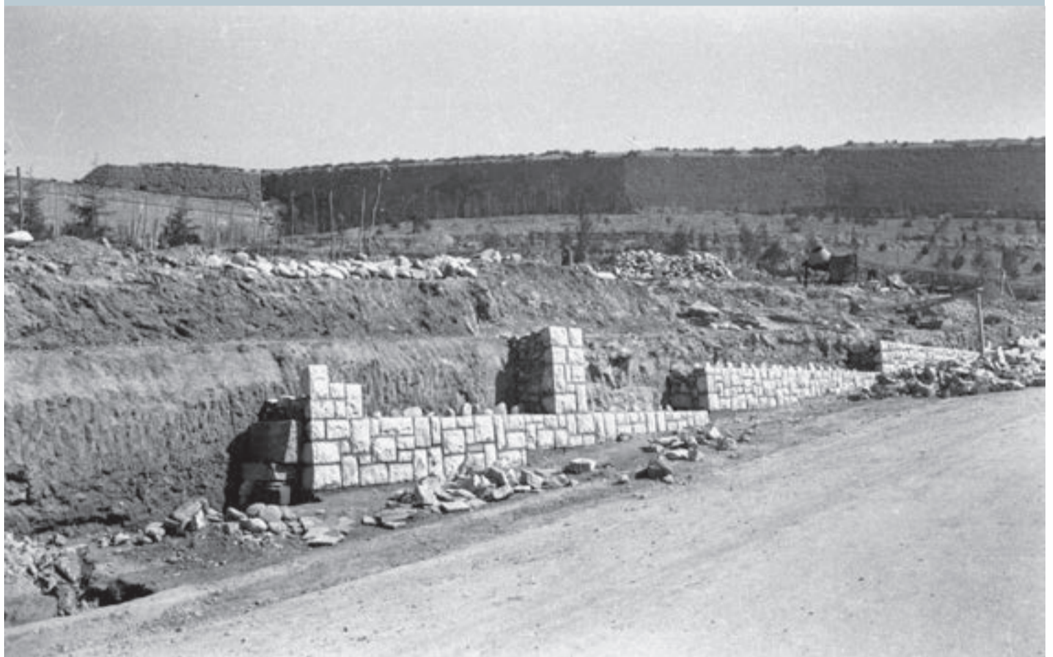
Obres de construcció del mur de contenció del carrer de Sant Martí. Fons Gómez Vidal (sense datar)
