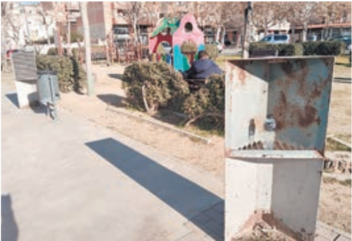
FOTO_ D.A. Un dels fanals en mal estat a la plaça
