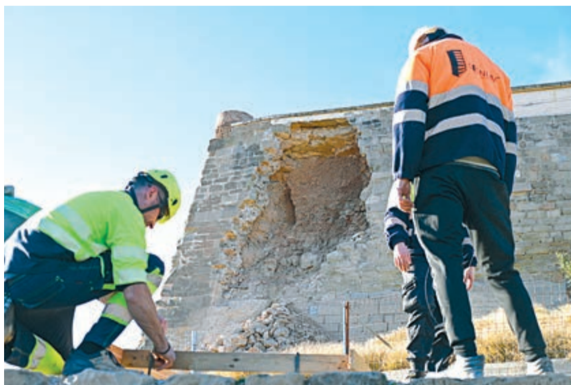
FOTO_ Núria García Operaris treballant en la retirada dels elements de la zona afectada
