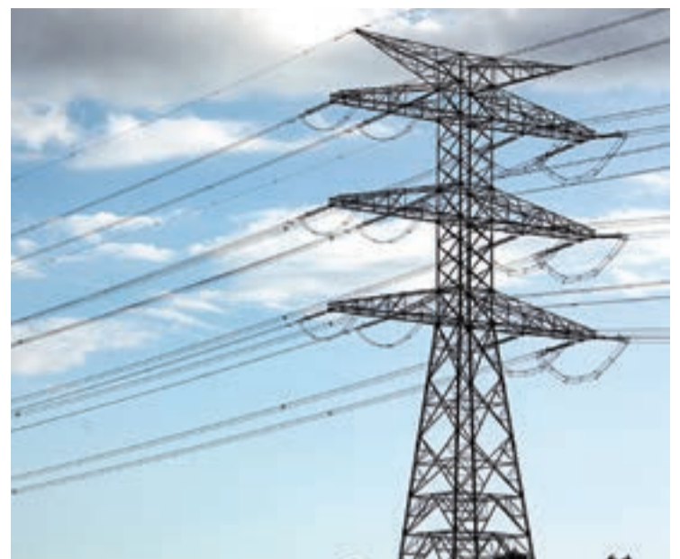
FOTO_ACN Imatge d'una torre d'alta tensió
