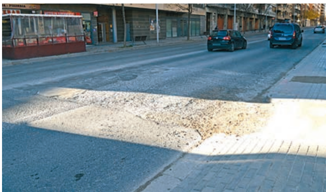
FOTO_ Núria García Tram en mal estat per les obres d'un col·lector de clavegueram
