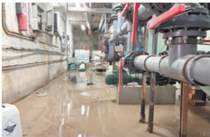
FOTO_ACN La sala de bombes inundada
