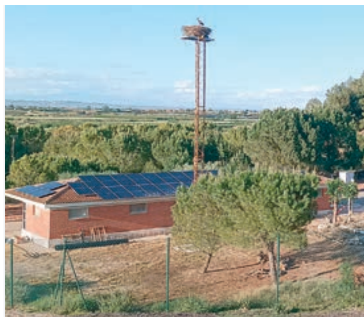
Golmés Plaques fotovoltàiques en la potabilitzadora
