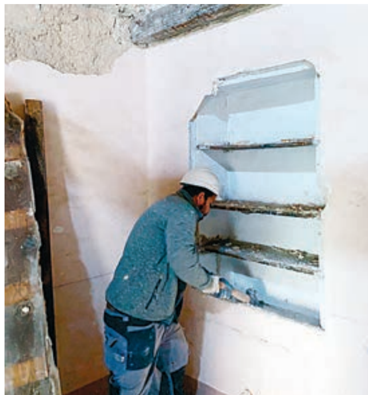
FOTO_ Ajuntament de Riner Els treballs permetran acabar pràcticament la restauració del segon pis de la Casa Gran
